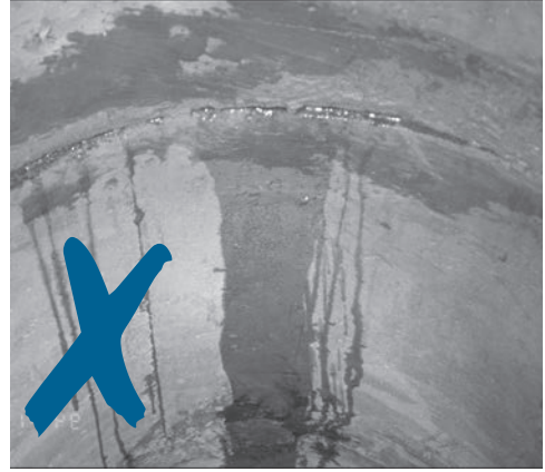
Cuvelage en ciment qui fuit.
