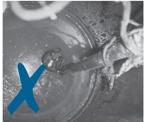
Eau de surface dans la fosse de visite d'un puits.
