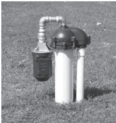
Puits foré avec capuchon de protection contre les inondations.
